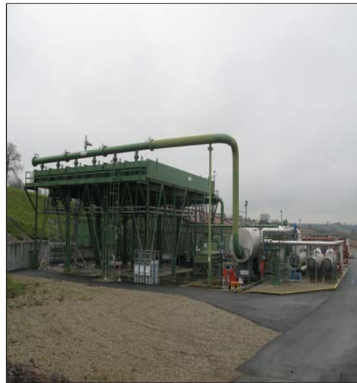
Abb. 4: Geothermische ORC-Kraftwerk in Soutz-sous-Forêts
