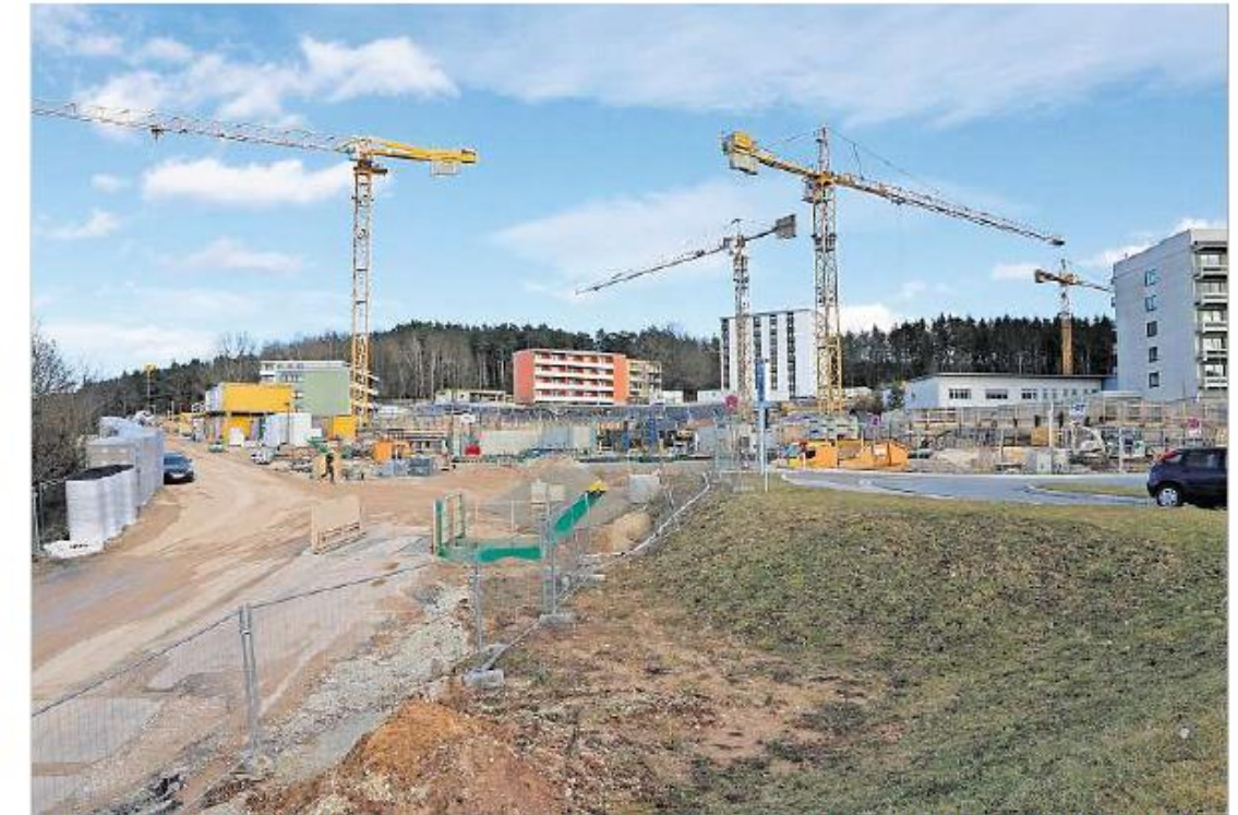
Der Klinikneubau in Lichtenfels will neue Standards setzen beim Energiemanagement. Wissenschaftlich wird das Projekt darum von nun an begleitet von den Hochschulen Hof und Coburg sowie der Universität Bayreuth.
